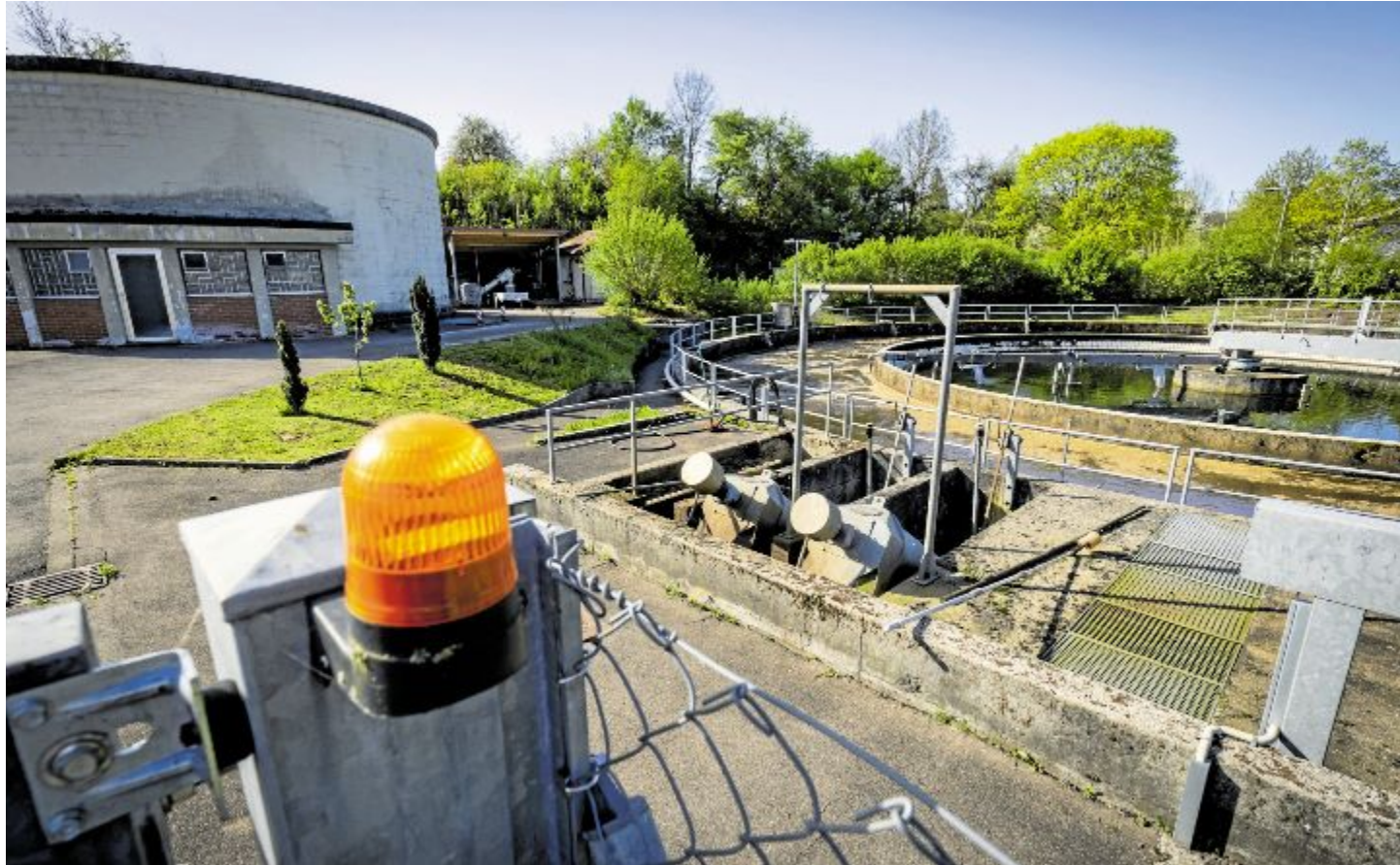
Bei einer Erweiterung der Anlage müsste voraussichtlich ein zweites Klärbecken her.
